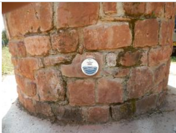
repère correspondant au niveau atteint par la crue du 04/12/2003
