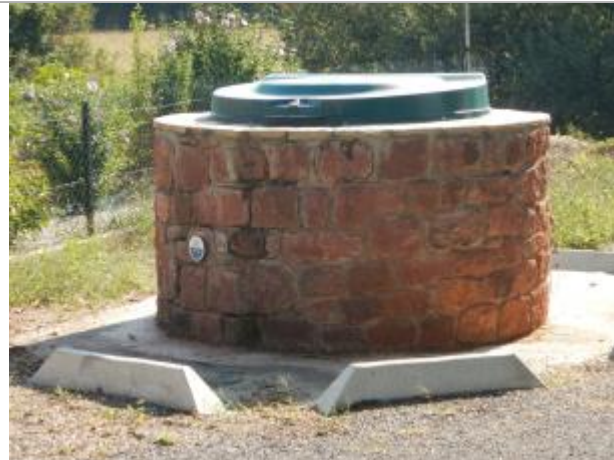
RA-1 : station de relevage des eaux usées de Manhac
