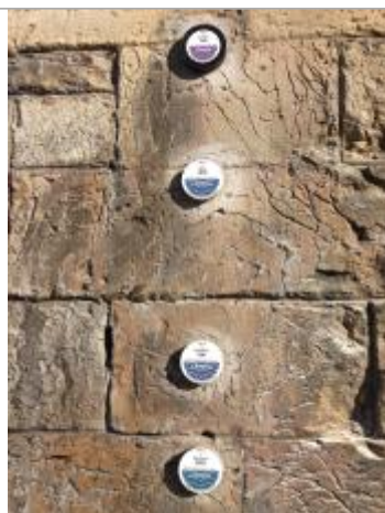
repère correspondant au niveau atteint par la crue du 03/03/1930 (2ème macaron en partant du haut sur la photo)
