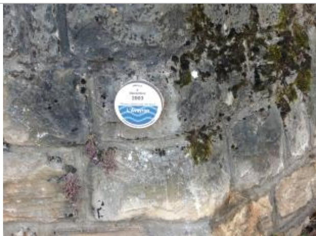
Repère du niveau atteint par la crue du 4 décembre 2003
