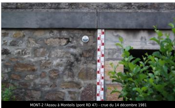
MONT-2 l'Assou à Monteils (pont RD 47) - crue du 14 décembre 1981
