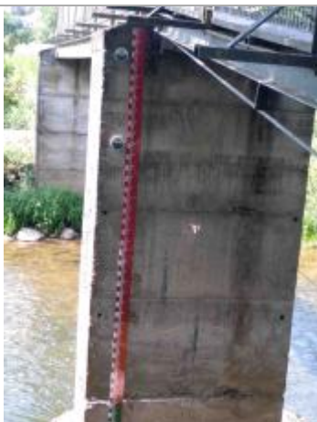
COMP-1 L'Aveyron au niveau de la passerelle du camping - crue du 14 décembre 1981 (repère haut)
