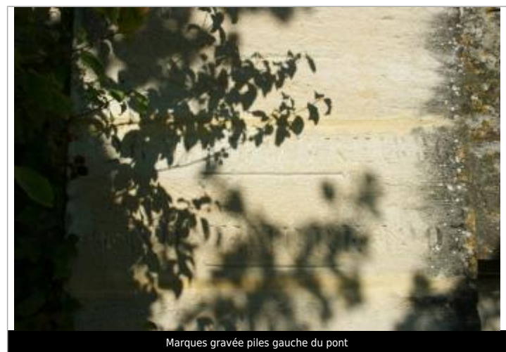
Marques gravée piles gauche du pont
