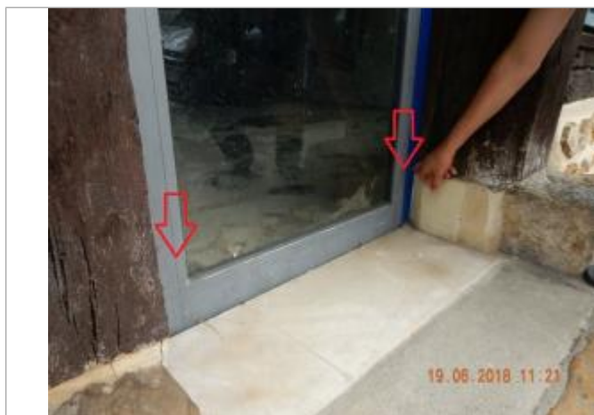
Laisses d'inondation sur la porte (photo SPC SACN)
