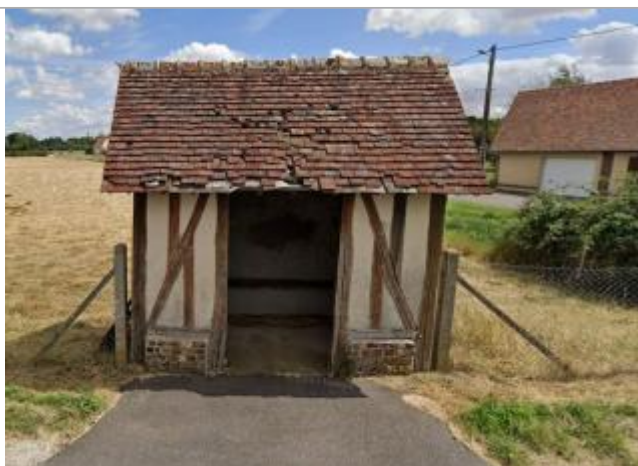
Laisse de crue sur le mur de l'abri bus
