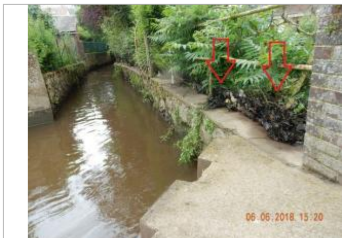
Dépôt de feuilles dans le grillage (photo SPC SACN)
