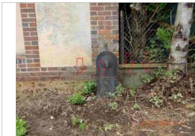
Laissez d'inondation sur la fontaine et les murs (photo SPC SACN)
