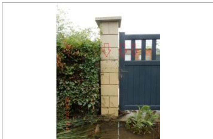
Laisses d'inondation sur le portillon (photo SPC SACN)
