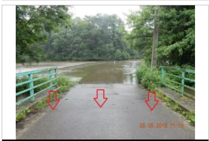
Laisses d'inondations sur le pont (photo SPC SACN)
