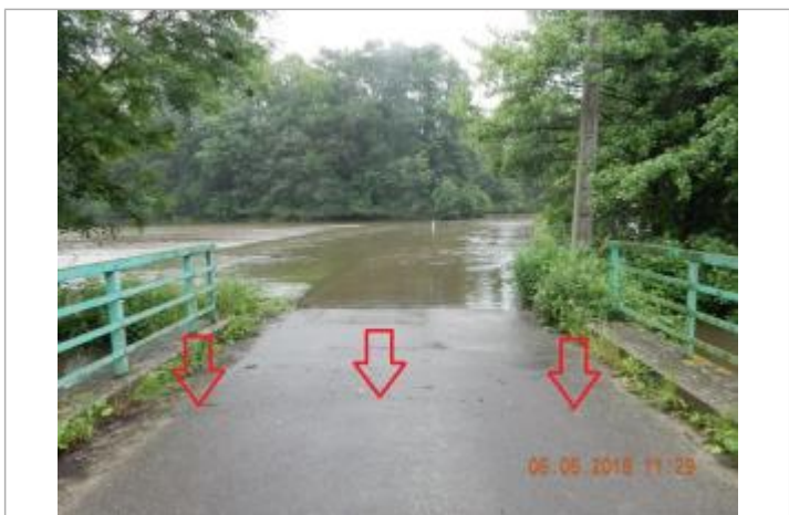
Laisses d'inondations sur le pont (photo SPC SACN)
