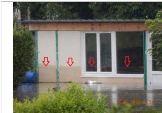
Traces laissées sur la façade du bâtiment (photo SPC SACN)
