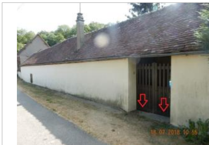
Laisses d'inondations sur le portail (photo SPC SACN)
