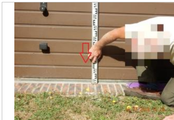
Laiesses d'inondation sur portail (photo SPC SACN)
