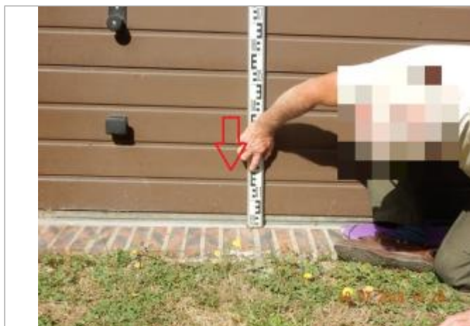
Laiesses d'inondation sur portail (photo SPC SACN)
