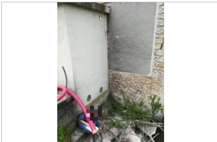
A proximité du transformateur EDF (photo SIVA)
