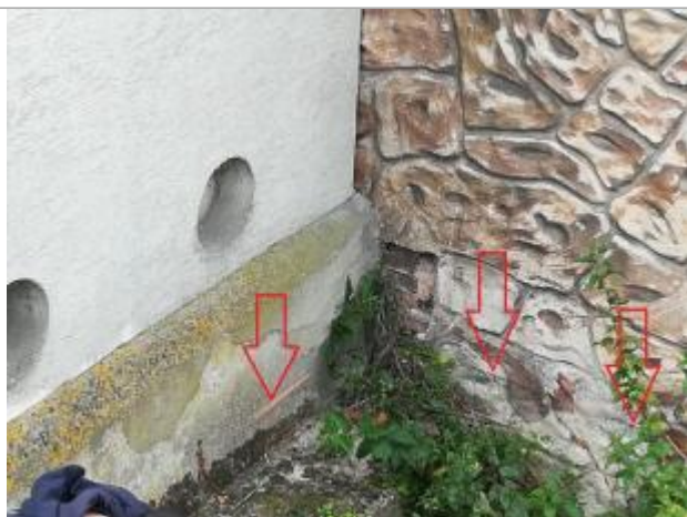
Débris laissés par l'inondation (photo SIVA)
