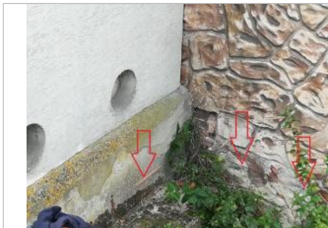
Débris laissés par l'inondation (photo SIVA)
