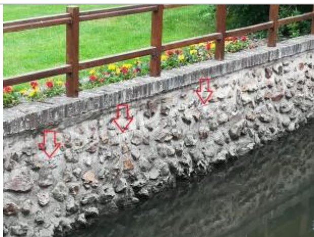
Traces laissées par l'inondation (photo SPC SACN)
