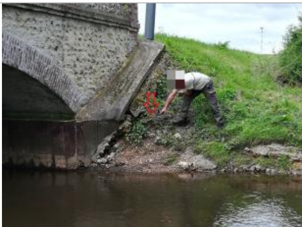
Dépôt de brindilles laissé par la crue (photo SPC SACN)
