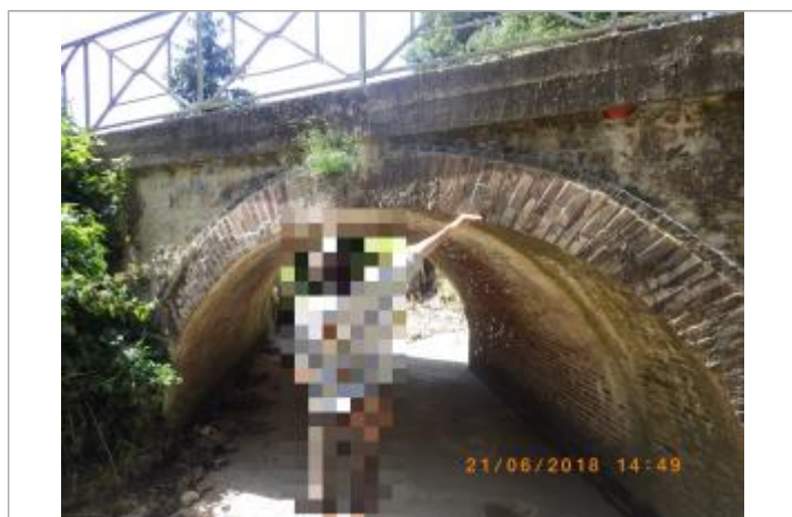
Pont quasiment en charge. Niveau matérialisé par la main (source : SPC SACN)
