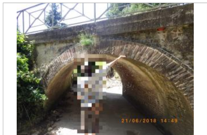
Pont quasiment en charge. Niveau matérialisé par la main (source : SPC SACN)
