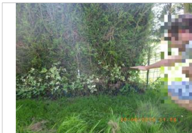
Laisse d'inondation visible sur le grillage, niveau matérialisé par la main (source : SPC SACN)
