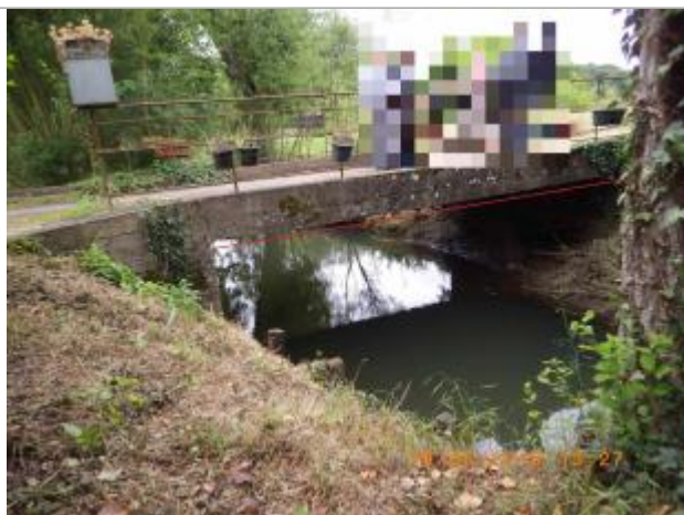
Niveau d'eau a presque atteint le tablier du pont (source : SPC SACN)
