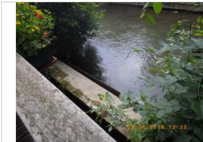
Seuil avec buse à sec (source : SPC SACN)
