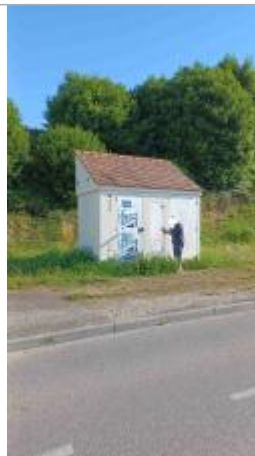
Transformateur Rue Charles Mérouvel (source : SPC SACN)
