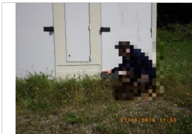
15 à 20 cm dans le transformateur EDF (source : SPC SACN)
