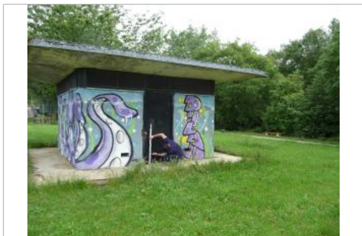
Trace sur la porte du bloc WC
