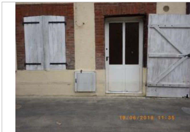
Traces d'hydrocarbures sur la façade de l'habitation, à 25 cm du sol (source : SPC SACN)
