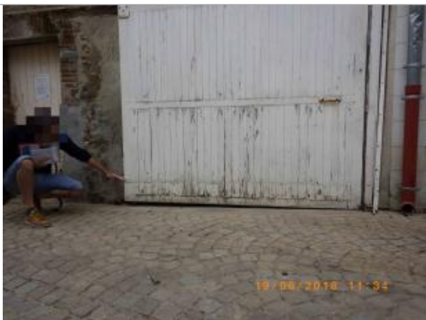
Niveau atteint sur la porte du garage, à 15 cm du sol (source : SPC SACN)
