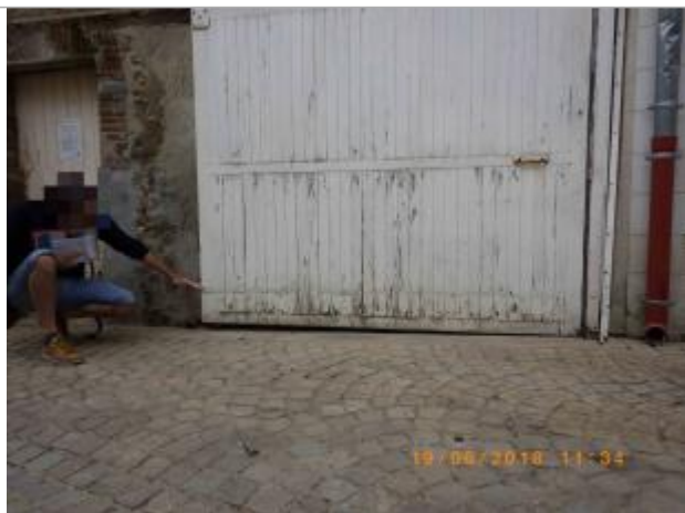
Niveau atteint sur la porte du garage, à 15 cm du sol (source : SPC SACN)
