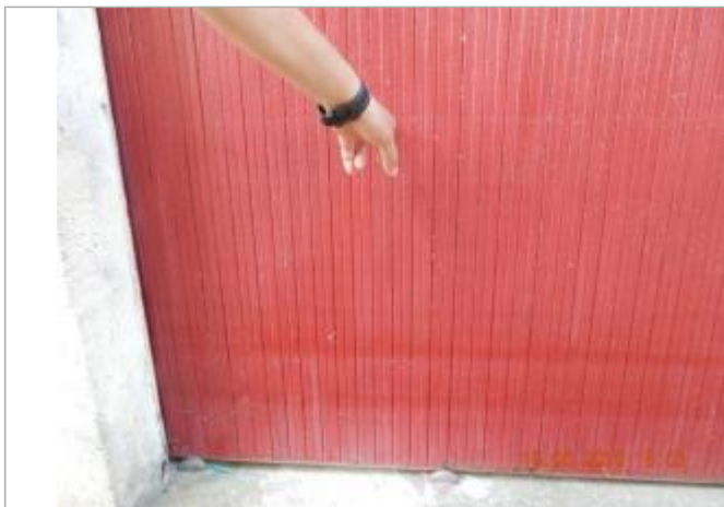
Traces laissées sur la porte du garage (photo SPC SACN)
