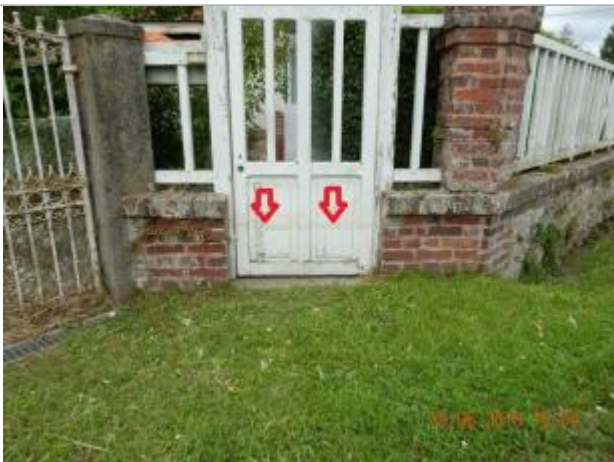
Traces sur le portail du presbytère (photo SPC SACN)
