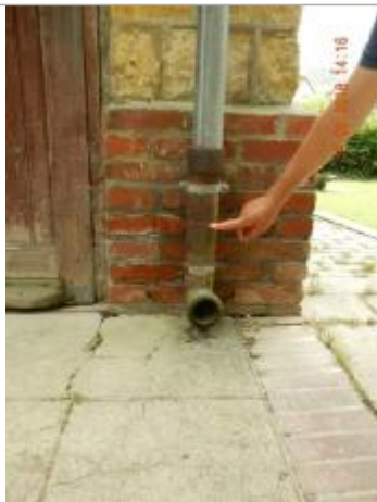
Dépôt de brindilles sur la gouttière (photo SPC SACN)
