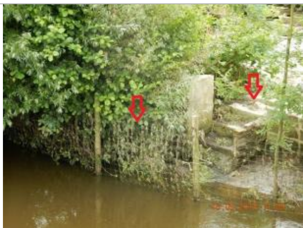
Dépôt de brindilles sur le grillage et de limons sur la troisième marche (photo SPC SACN)
