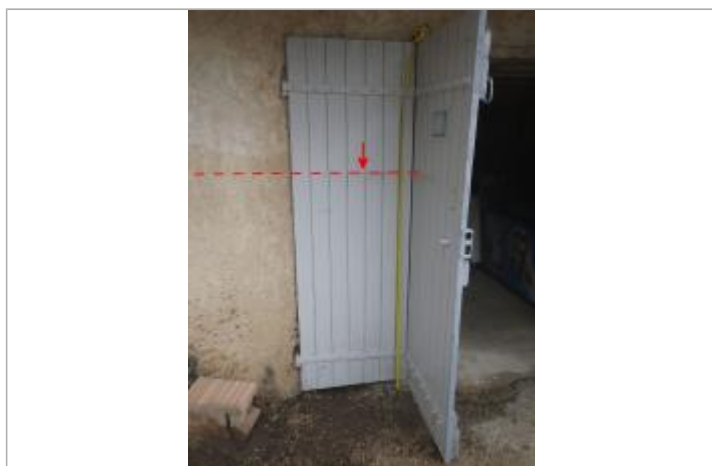
Vue de la laisse d'inondation - Auteur : AGERIN
