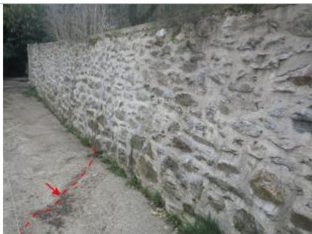
Vue de la laisse d'inondation - Auteur : AGERIN
