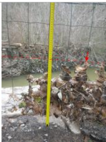
Vue de la laisse d'inondation - Auteur : AGERIN
