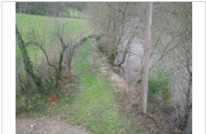
Vue de la laisse d'inondation - Auteur : AGERIN
