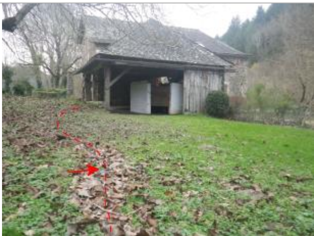
Vue de la laisse d'inondation - Auteur : AGERIN
