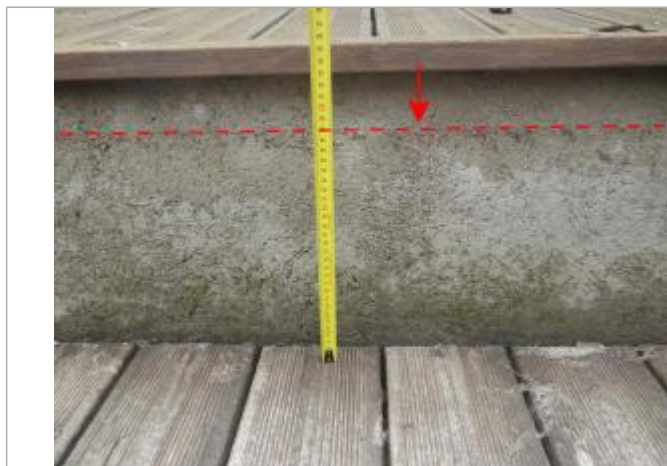
Vue de la laisse d'inondation - Auteur : AGERIN
