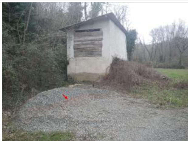
Vue de la laisse d'inondation - Auteur : AGERIN
