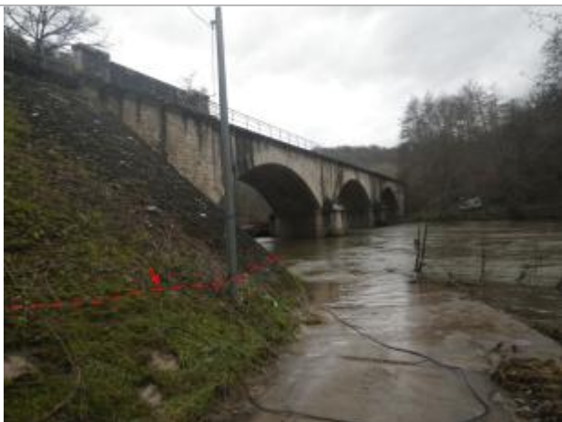
Vue de la laisse d'inondation - Auteur : AGERIN
