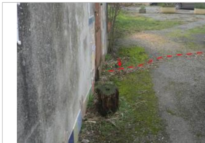
Vue de la laisse d'inondation - Auteur : AGERIN
