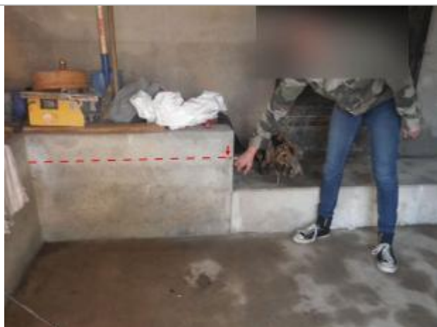
Vue de la laisse d'inondation - Auteur : AGERIN
