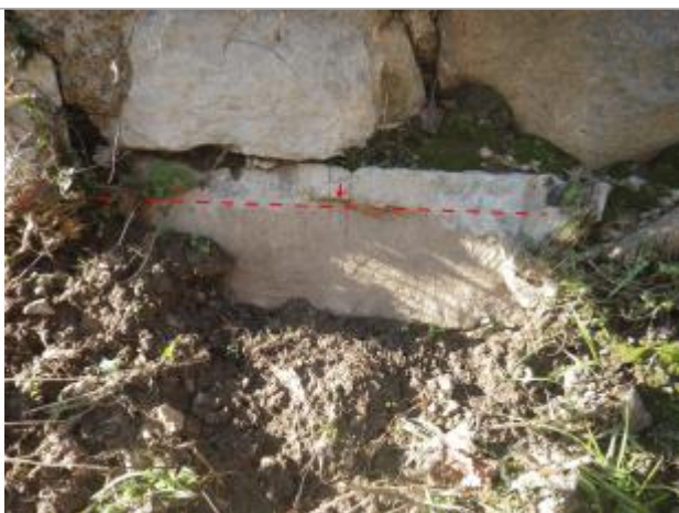
Vue de la laisse d'inondation - Auteur : AGERIN
