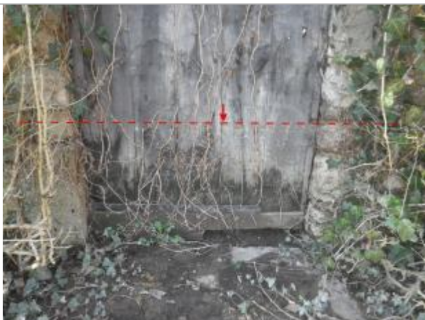
Vue de la laisse d'inondation - Auteur : AGERIN
