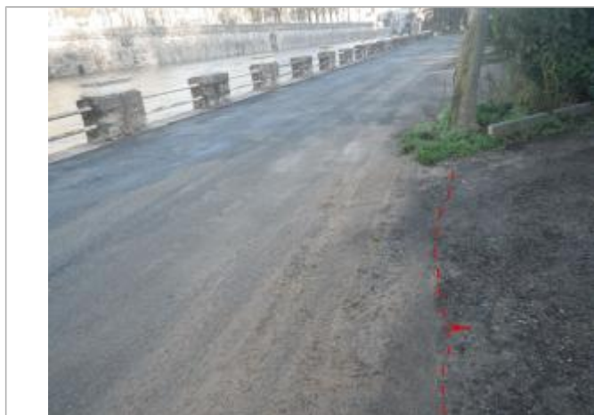
Vue de la laisse d'inondation - Auteur : AGERIN
